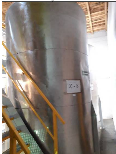
23. Zbiornik stalowy Z8 9.000 l. kwasoodporny h-3 m Fi 2 m
